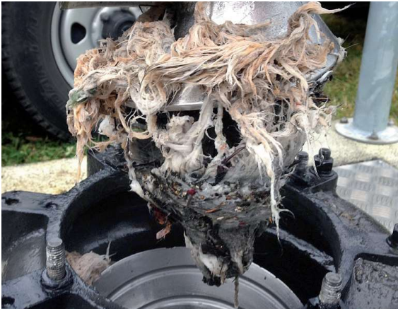
Verstopfte Pumpen, aufwändige Instandstellung.
